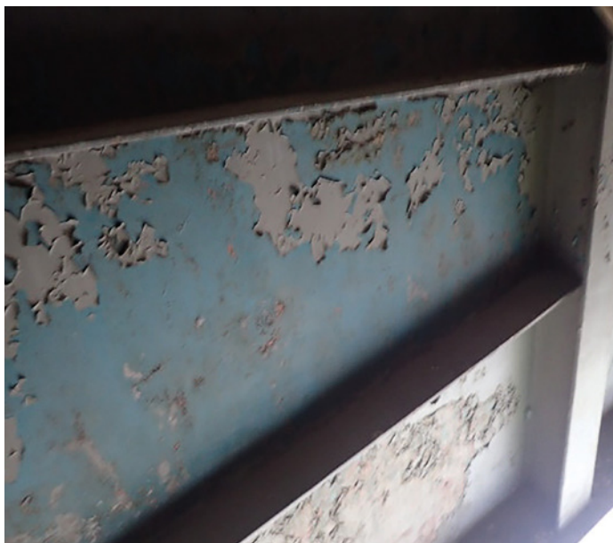
Obr. 12 Odlupování PKO na hlavním nosníku [3]
