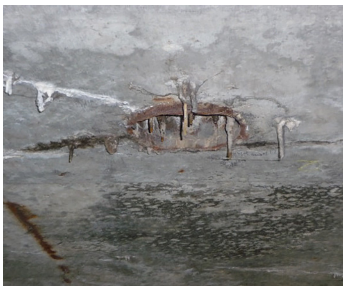
Obr. 16 Nedostatečné krytí betonářské výztuže [3]
