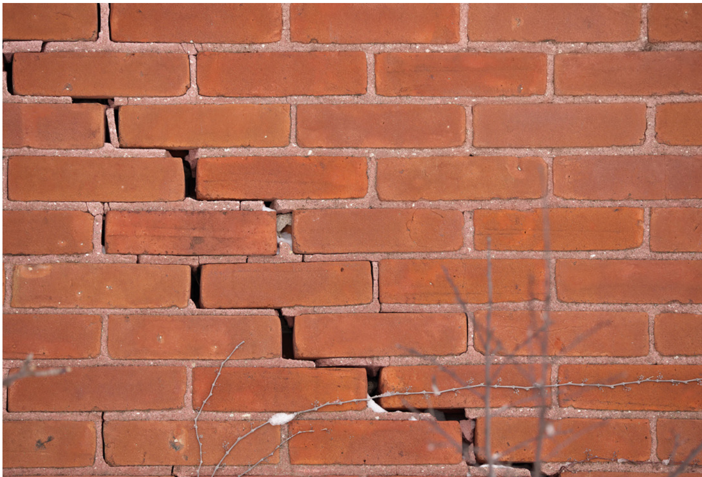
Trhliny ve stavební konstrukci, ilustrační foto (www.shutterstock.com)
