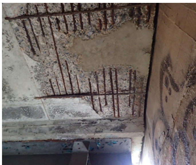
Obr. 17 Koroze betonářské výztuže [3]
