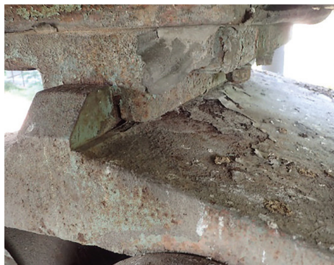
Obr. 15 Nefunkční PKO ložiska [3]
