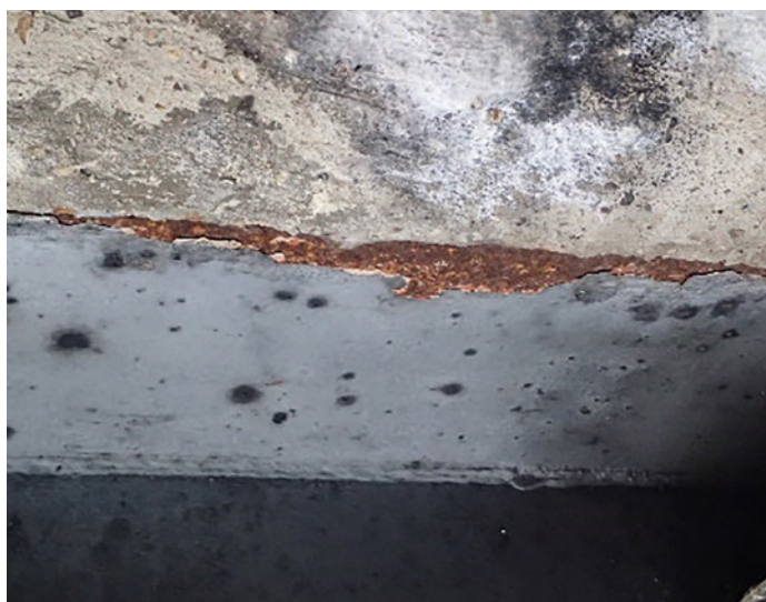
Obr. 14 Koroze horní pásnice hlavního nosníku na styku s betonovým žlabem [3]
