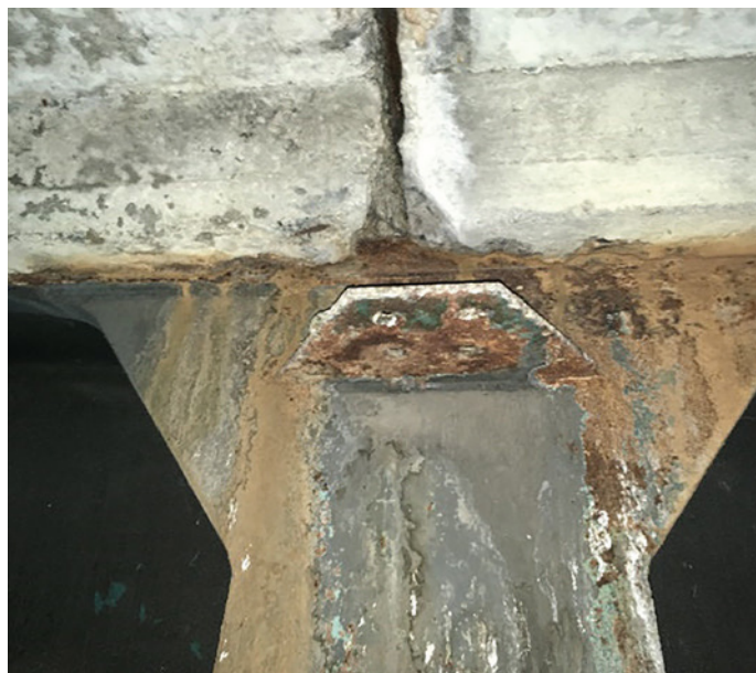
Obr. 13 Koroze horní pásnice hlavního nosníku pod dilatační spárou betonového žlabu [3]
