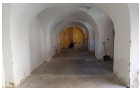
Obr. 16 Olomouc, palácová stavba, poruchy zdiva způsobené vlhkostí
