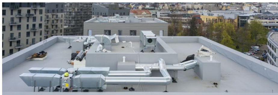
▲ Obr. 20 Vzduchotechnické systémy na střeše věže bytového domu
