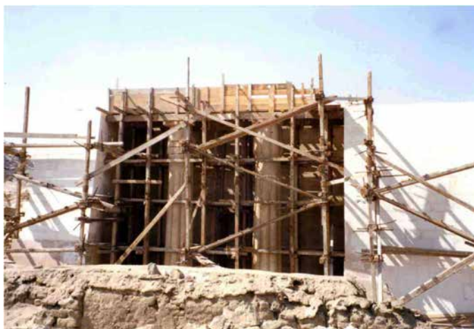
▲ Obr. 11 Pro vytvoření architrávu byl navržen dutý nosník, který se v žádném případě nesměl „prohnout“ a zatížit osmistvolové sloupy
