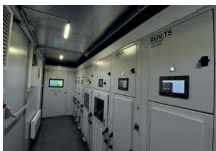
▲ Obr. 3 Kontejner 660 V DC – rozváděče trakční technologie
