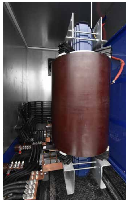
▲ Obr. 6 Kontejner 22 kV AC – trakční transformátor
