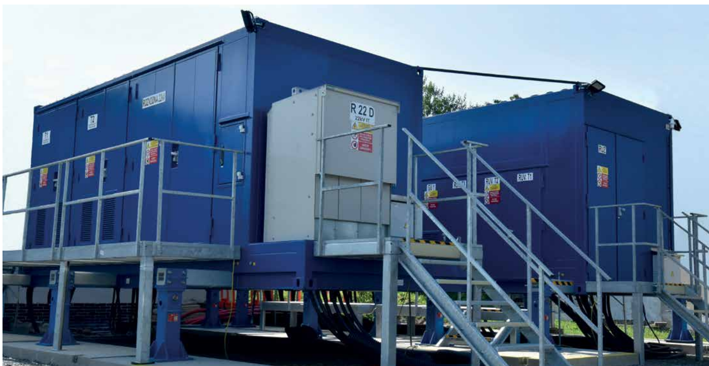
▲ Obr. 1 Převozná kontejnerová měnírna – celkový pohled na sestavu kontejnerů
