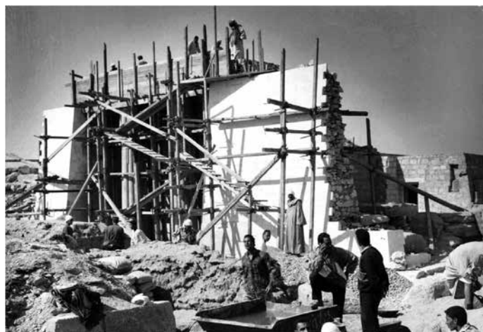
▲ Obr. 10 Průběh dostavby a obnovy piliřového portiku. Pro ilustraci je možné zmínit, že celá stavba probíhala ručně, včetně dopravy i míchání betonu.
