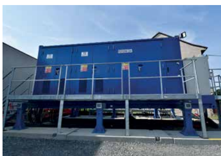
▲ Obr. 5 Kontejner 22 kV AC
