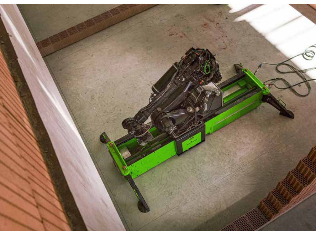
▲ Obr. 5 Po vyzdění určité délky zdi je robot schopen samostatného posunu podél vyzdívané stěny do další pozice
