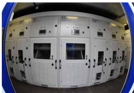
▲ Obr. 2 Kontejner 660 V DC – pohled do interiéru od vchodu
