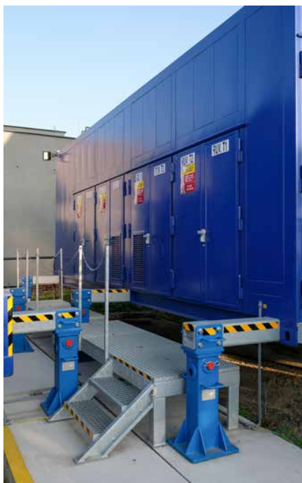
▲ Obr. 4 Kontejner 660 V DC – boční pohled
