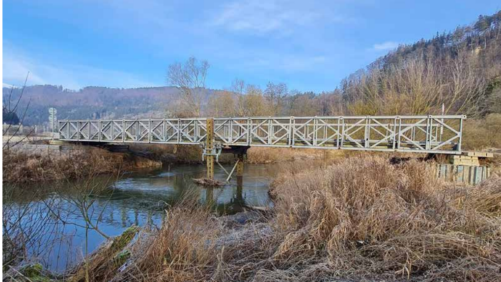
▲ Obr. 6 Nepřístupná železniční trať si vynutila i výstavbu provizorního přemostění Tiché Orlice a navazujících komunikací
