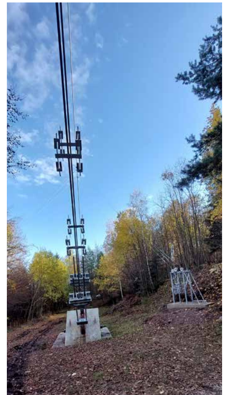
▲ Obr. 16 Vysokofrekvenční pohlčovače na laněch a nízkofrekvenční tlumiče na pomocné konstrukci na zemi (foto: Jindřich Syrovátka)
