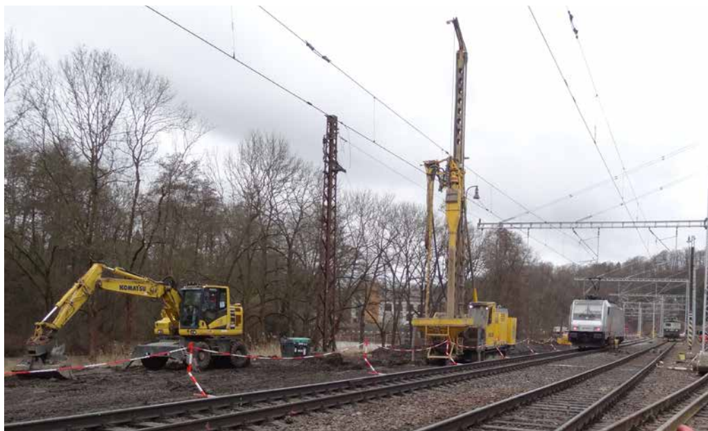
▲ Obr. 7 Realizace vibrovaných šterkových pilířů pro zpevnění tělesa trati vybudovaného původně z jílovitých zemin (foto: Ing. Lenka Němcová)
