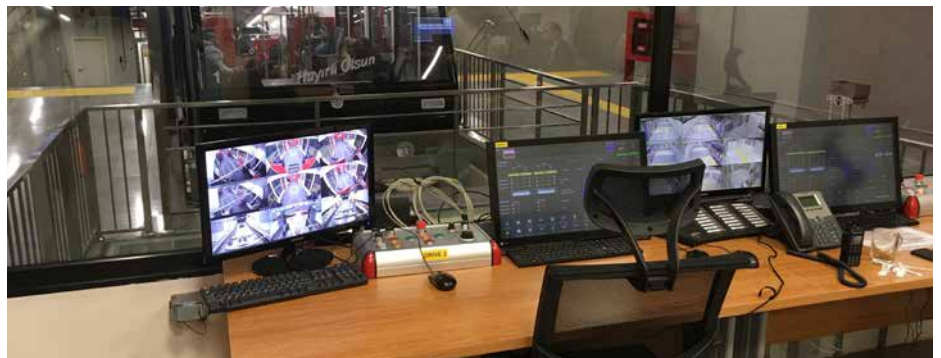
▲ Obr. 16 Velín v horní stanici (zdroj: archiv stavby)
