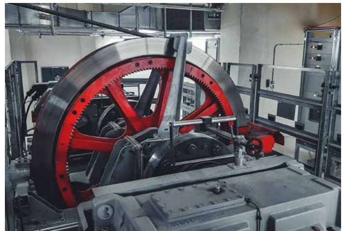
▲ Obr. 15 Strojovna lanovky (zdroj: webové stránky fy Garaventa)
