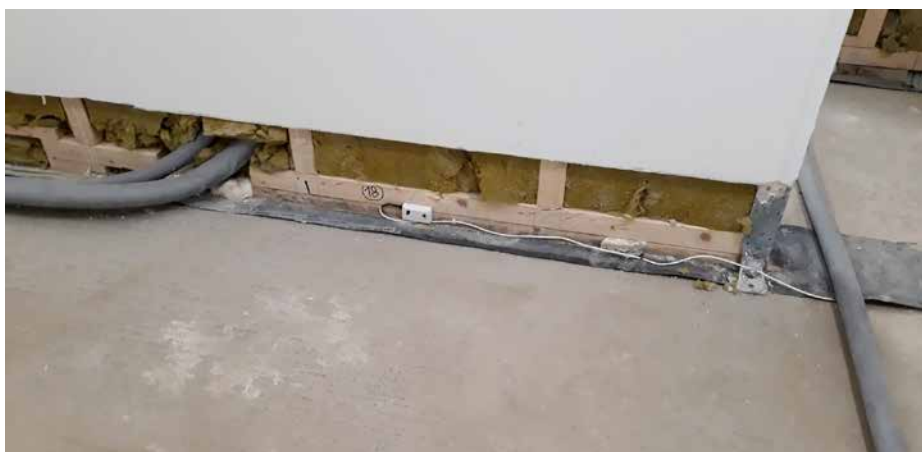
▲ Obr. 6 Senzor MHT poskytující data o vlhkosti při vysoušení a monitorující konstrukci při jejím následném uzavření (zdroj: www.moistureguard.cz )
