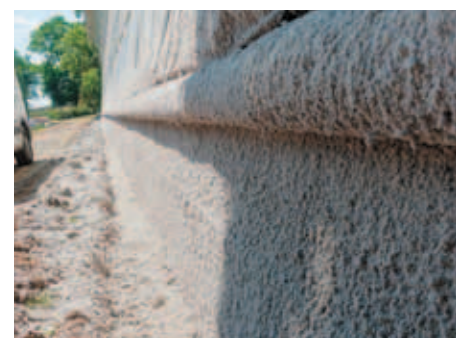
▲ Nástřik odsolovacích obkladů z celulózy na rozsáhlé plochy historické kamenné podezdívky oranžerie.
